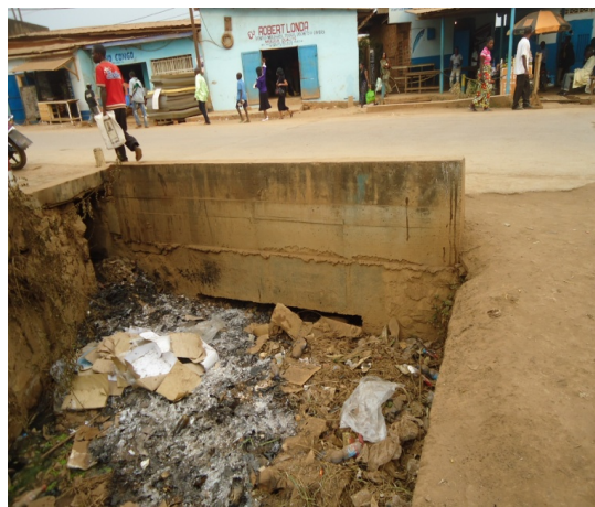
Vertido en la zona de evacuación de aguas pluviales a su paso por la Nacional 1
