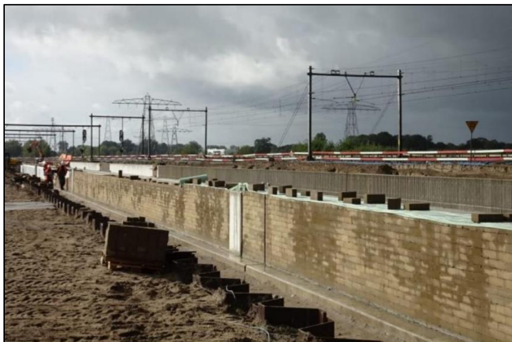
Ilustración 32. Ejemplo de una barrera acústica construida con sedimentos excavados en la construcción de un túnel de ferrocarril. Fuente: Geowall en Deltares, jornadas Sediment Management, 2021
