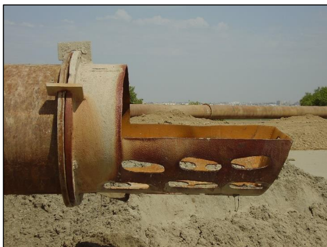
Ilustración 263. Filtro de retención de materiales colocado en la boca de salida de la tubería.
