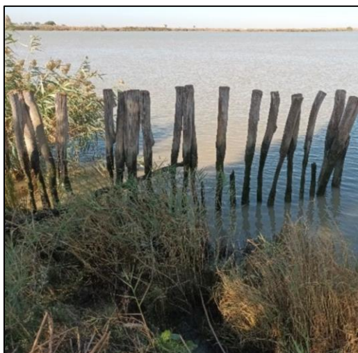
Ilustración 193. Restos de medida de estabilización de márgenes en Isleta. Fuente: Tecnoambiente, 2022.
