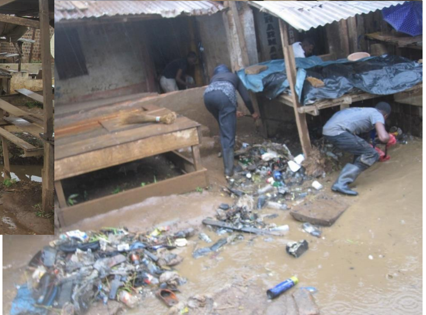
Mercado en estaciones lluviosas. Los trabajadores intentan desatascar el canal que lleva el agua a la carretera.
