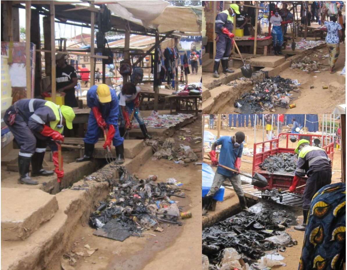
Avenida de comercio. Canalización de las aguas pluviales, la de los comercios y viviendas construidos para tal fin en cemento. Se puede observar en primer plano una placa de cemento que sirve de paso. La basura acumulada junto a las aguas ha formado fango.
