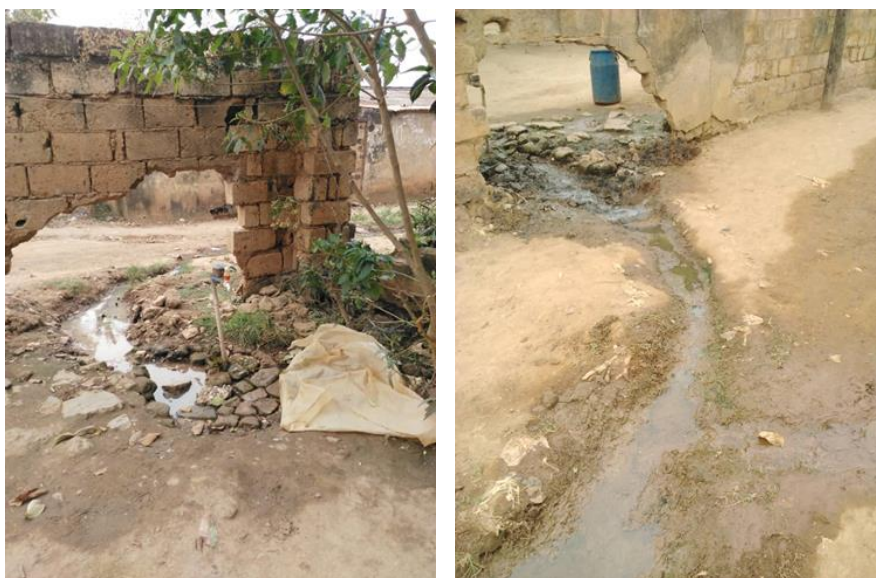
Salidas del agua procedente del grifo y de uso doméstico hacia la calle, que se une con el agua que discurre de otras viviendas y del agua de lluvia.
