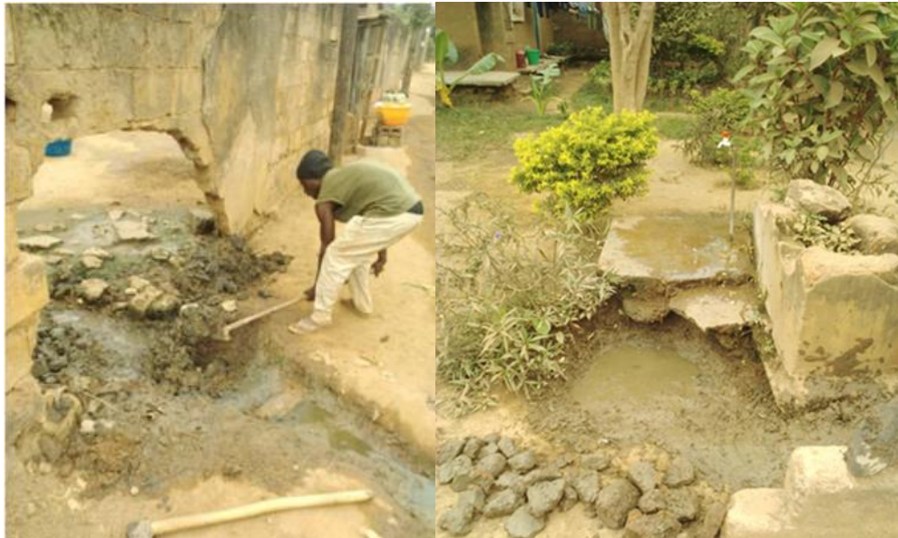
Preparación de la zona de acumulación y salida del agua de la parcela mediante la excavación de un canal. El canal se rellenó con piedras como trabajo complementario al del pozo de infiltración
