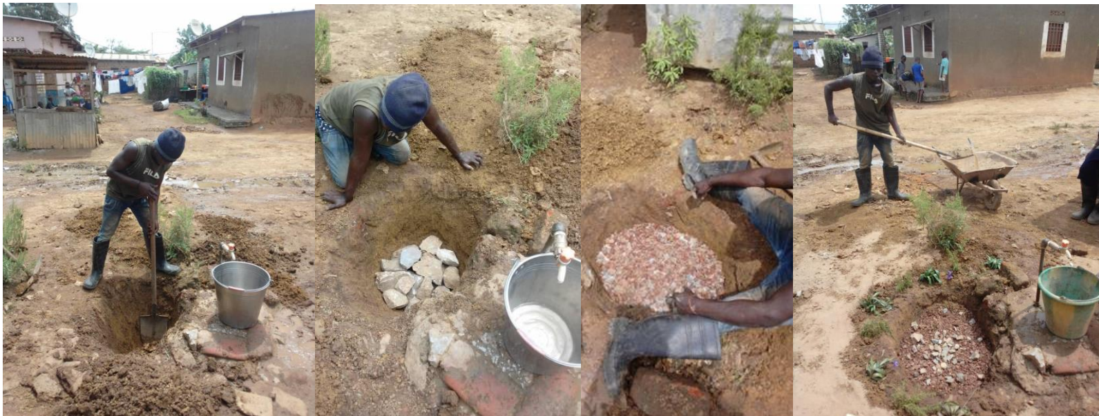
Apertura de un hoyo circular en el lugar donde se acumula el agua, con una profundidad de 1m. Colocaron piedras del tamaño de una palma de mano, con un grosor de unos 20 cm, seguida por piedras de menor tamaño hasta la tierra fina de la superficie.
