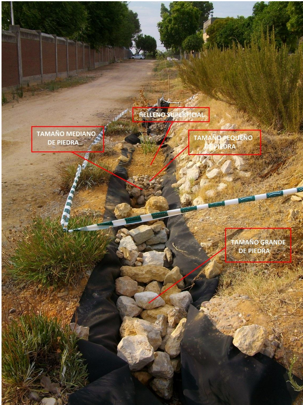
Fig. 7 – Podemos observar en esta fotografía la colocación de piedras en el canal según los diferentes tamaños.
