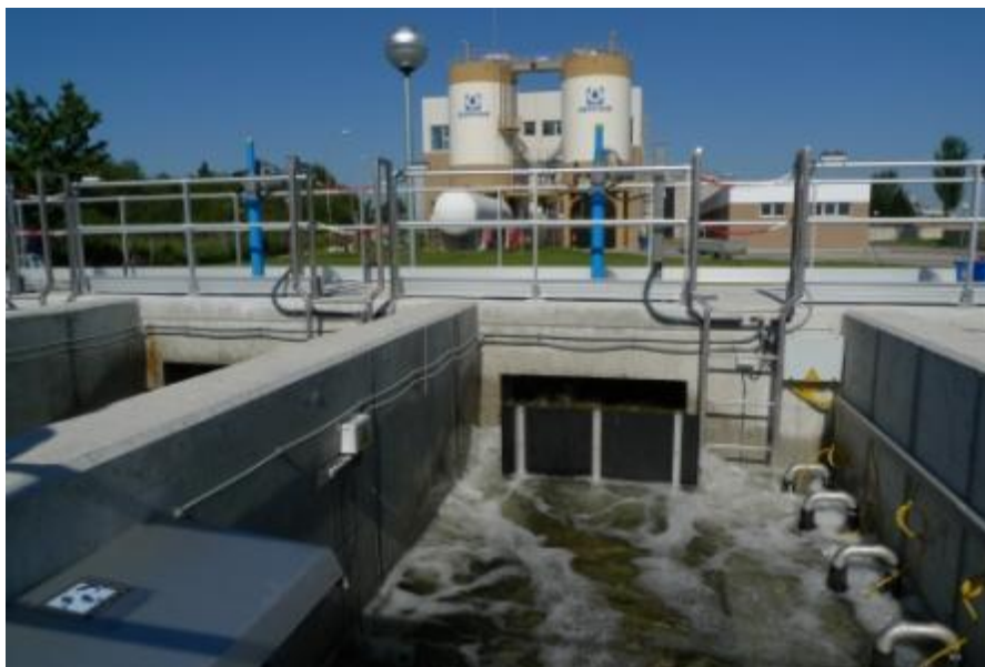
Figura 15. Sistema de filtración. Fuente: DAM,2015
