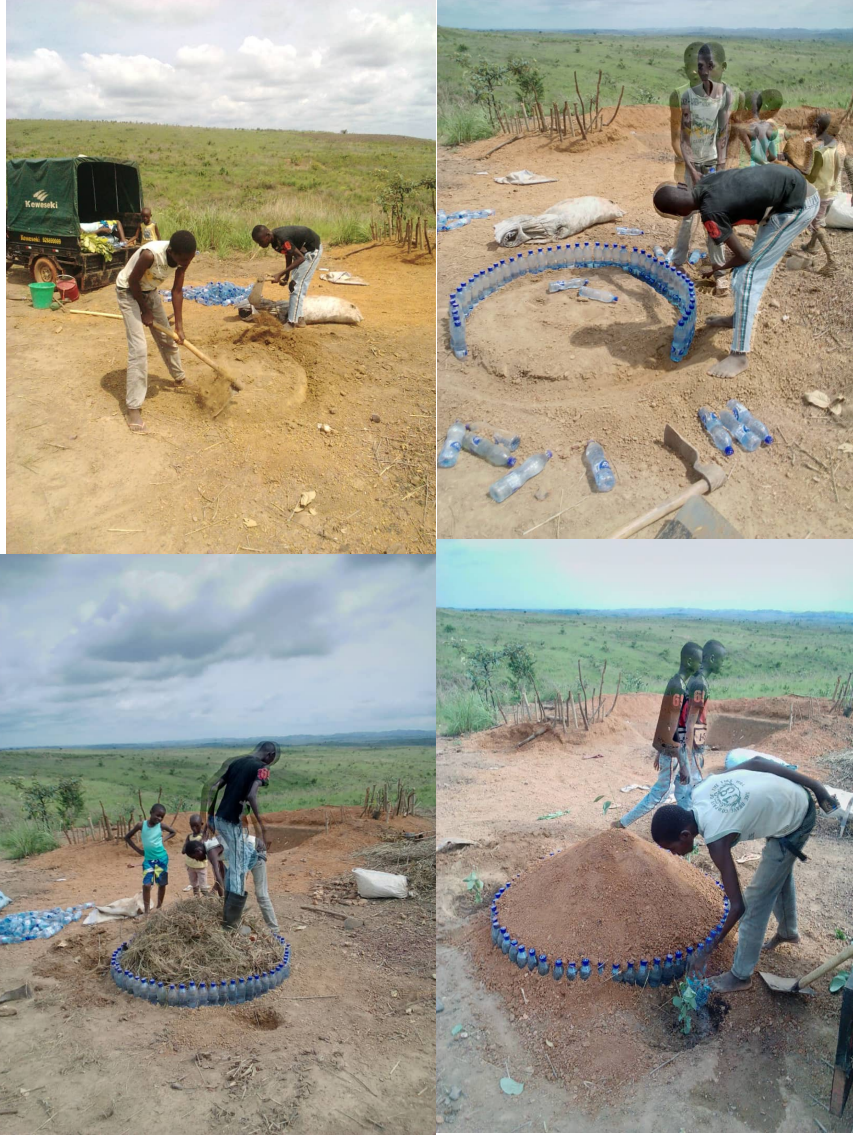
Fotos 85-88: Preparación de pequeña rotonda para la circulación de los vehículos de descarga de la basura
