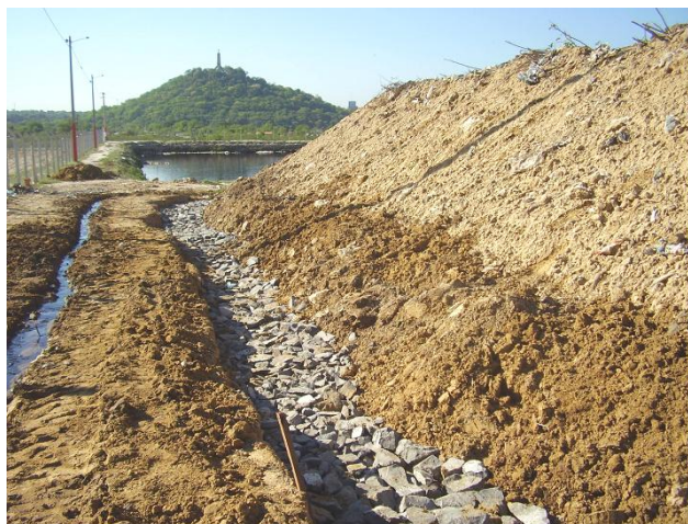
Figura 23 Dren de Lixiviado en Plataforma
