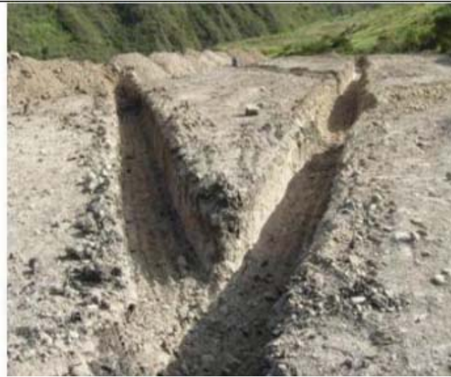
Figura 22 Dren de Lixiviados en Trinchera
